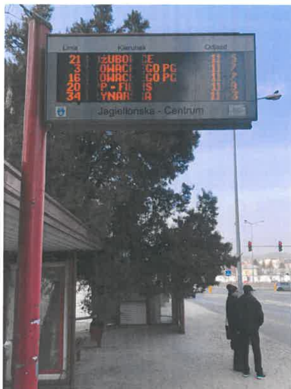
Rys. 10.1 Elektryczna tablica przystankowa w Przemysłu
