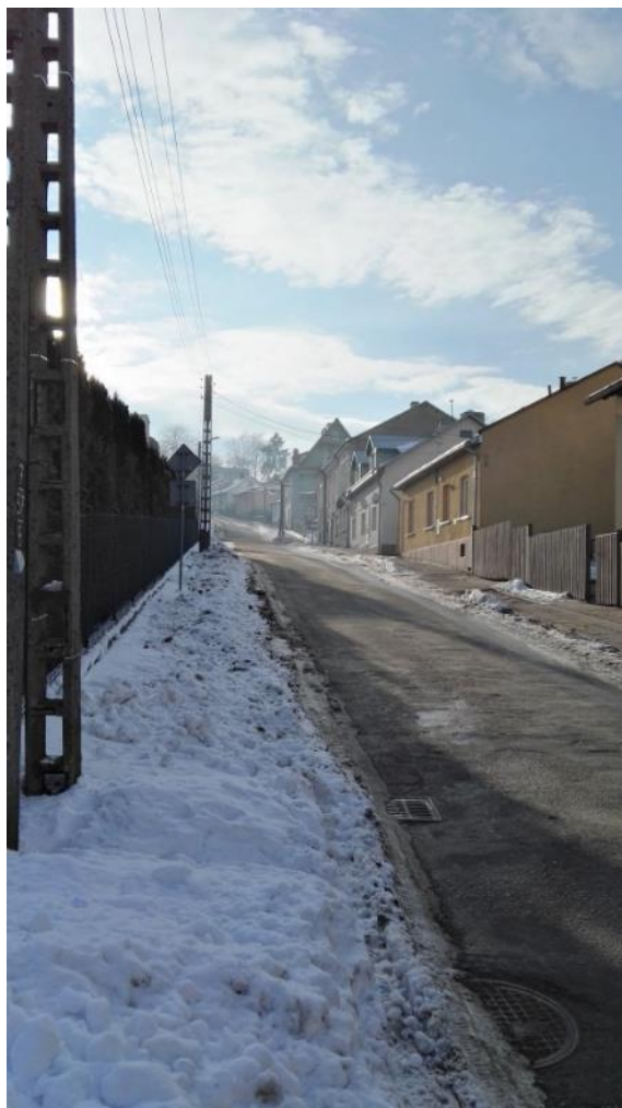
Fot. 17 i 18 Nawierzchnia ulicy Tatarskiej (nawierzchnia bitumiczna, spękana).
